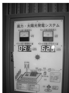
風力・太陽光発電設備
